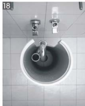
ペDESTAL設置後の上部からの写真です。写真では、床の排水口位置はペDESTALの内部側ですが、通常は、ペDESTALの外部側の設置となります。
